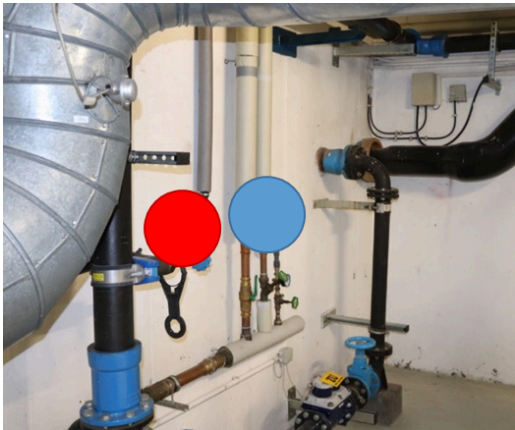
Abbildung 10: Gebäudeeintritt im Untergeschoss HKW KH
